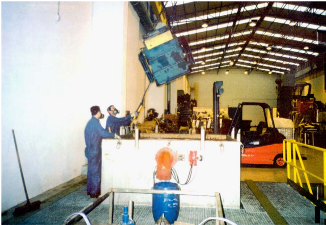
Travailleurs équipés de vêtements de protection lors de travaux sur un transformateur PCB
