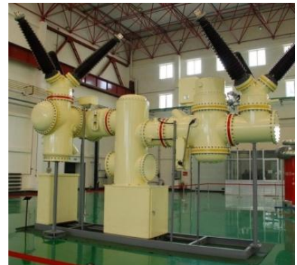
Installation isolée au SF 6
