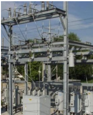
Installation isolée à l'air
